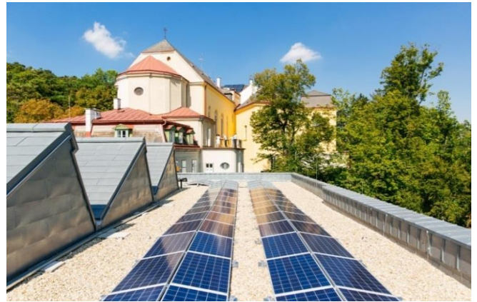
Foto: Photovoltaikanlage in Sta. Christiana/ Wien (c) Tausendundein Dach/T. Gigov
