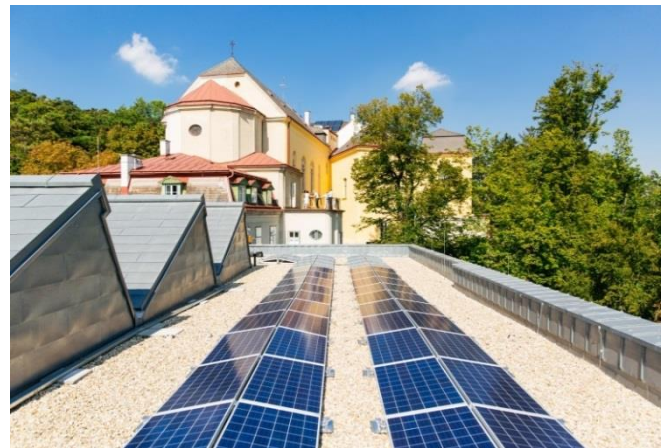
Foto: Photovoltaikanlage in Sta. Christiana/ Wien (c) Tausendundein Dach/T. Gigov
